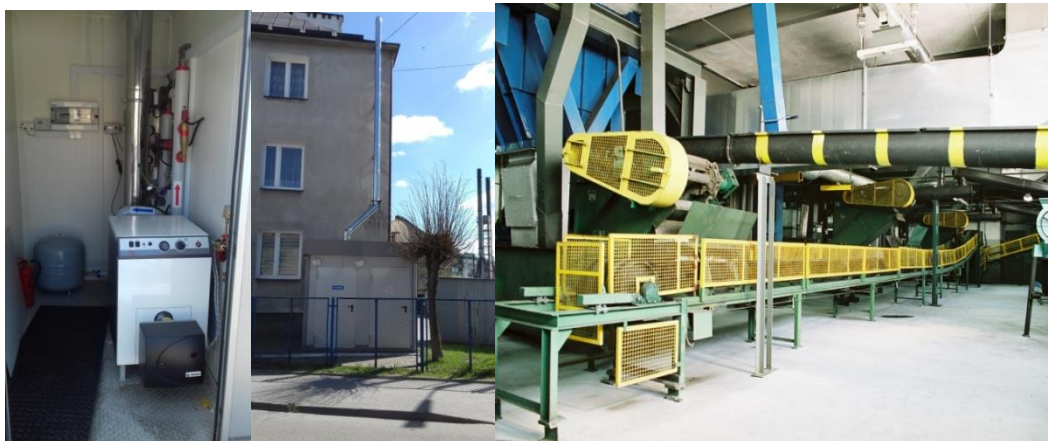
Kotłownia kontenerowa ul. Żwirki i Wigury 3
