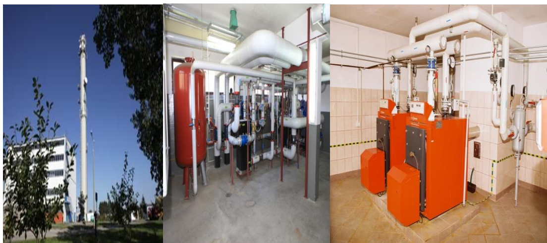
Widok ogólny kotłowni centralnej
