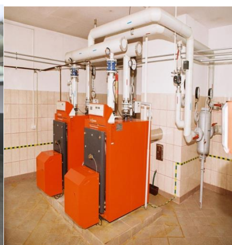
Kotłownia olejowa ul. Dubiażyńska 2a
