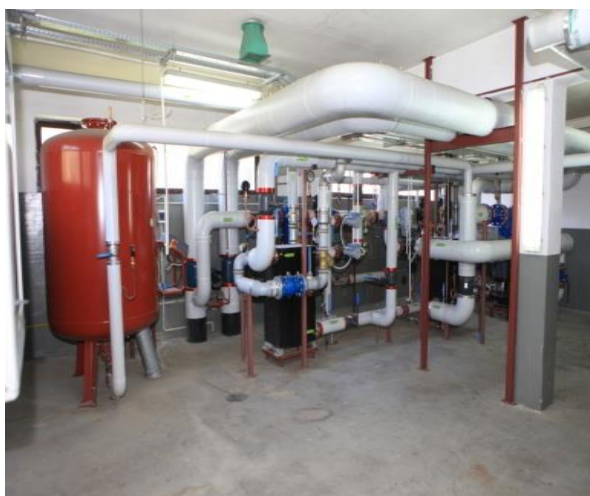
Grupowy węzeł cieplny
