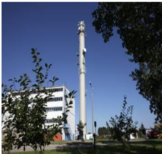
Widok ogólny kotłowni centralnej
