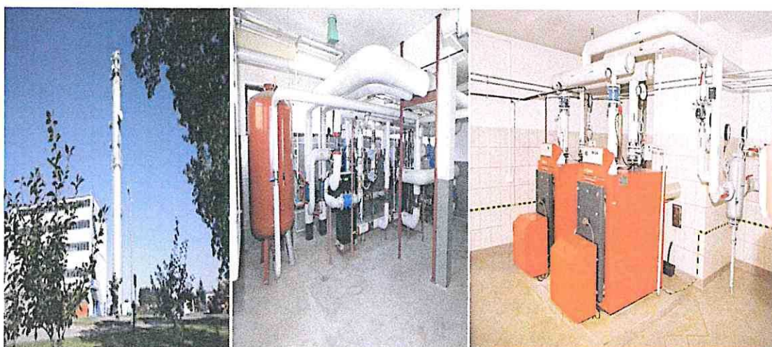
Widok ogólny kotłowni centralnej
