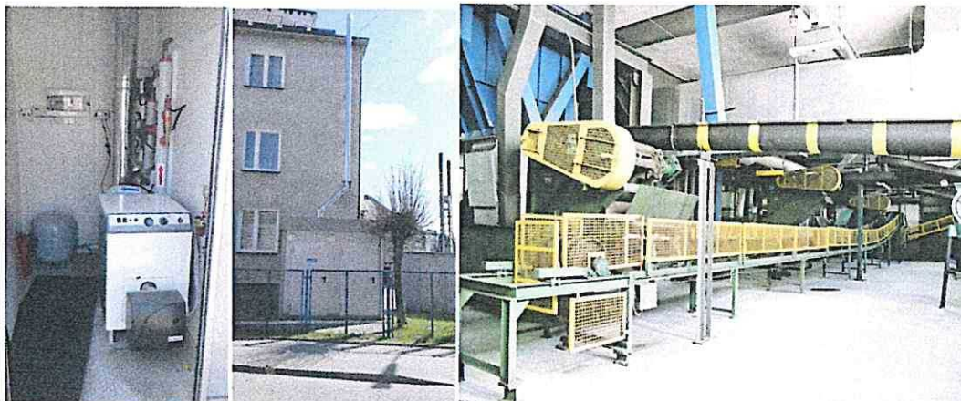
Kotłownia kontenerowa ul. Żwirki i Wigury 3
