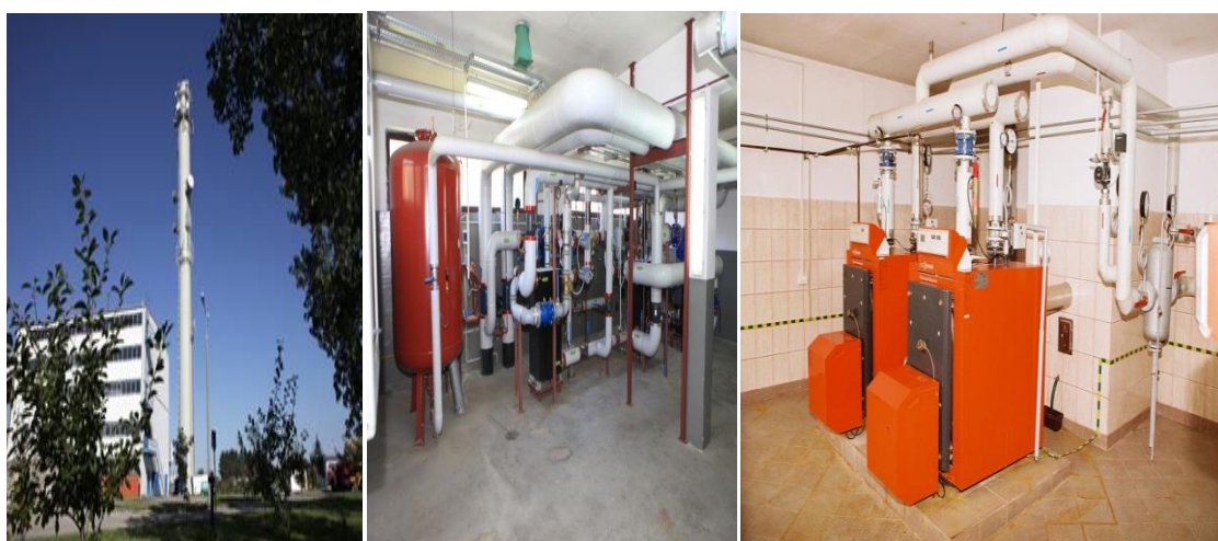
Widok ogólny kotłowni centralnej
