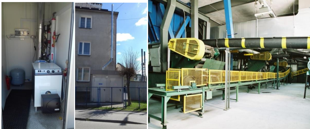
Kotłownia kontenerowa ul. Żwirki i Wigury 3
